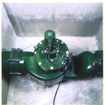
●破砕機 排水中の固形物を細かく破砕し、十分に生物処理できるよう前処理します。
