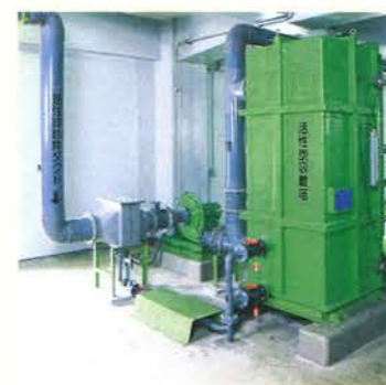
●活性炭脱臭装置 汚泥処理系の高濃度臭気を活性炭により、吸着除去します。
