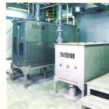
●スクリーン槽・汚水計量槽 スクリーン槽にて、し渣分を除去し、汚水計量槽にてオキシデーションディッチ槽に流入する汚水の量を一定にします。
