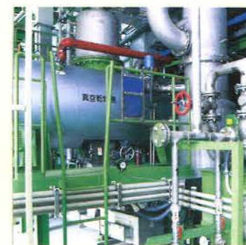
●汚泥乾燥装置 脱水汚泥をさらに乾燥して水分を減らし、容積約1/5の乾燥汚泥として場外に搬出します。
