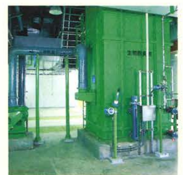
●生物脱臭装置 水処理系の低濃度臭気を微生物の働きによって分解除去します。
