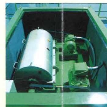
●汚泥脱水機 生物処理にて発生した汚泥を沈殿させ脱水を行います。
