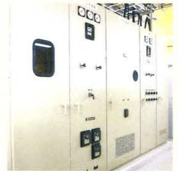
●引込受電盤・変圧器盤 受電した後、それぞれの施設に電力を供給するために、変圧を行います。
