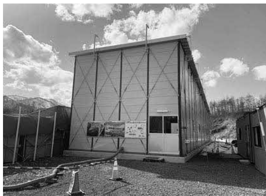
村山地区受入地で稼働中のセレン浄化システム 〔提供：JRTT鉄道・運輸機構〕
