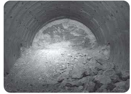
北海道新幹線渡島トンネル (南鶉工区)掘削状況のようす 〔提供：JRTT鉄道・運輸機構〕
