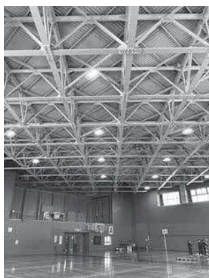
LED照明の北斗市スポーツセンター
