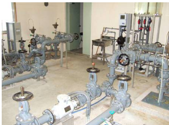
茂辺地ポンプ場
