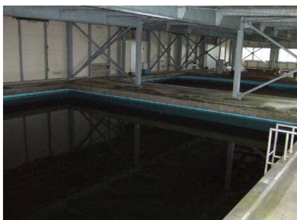
茂辺地浄水場
