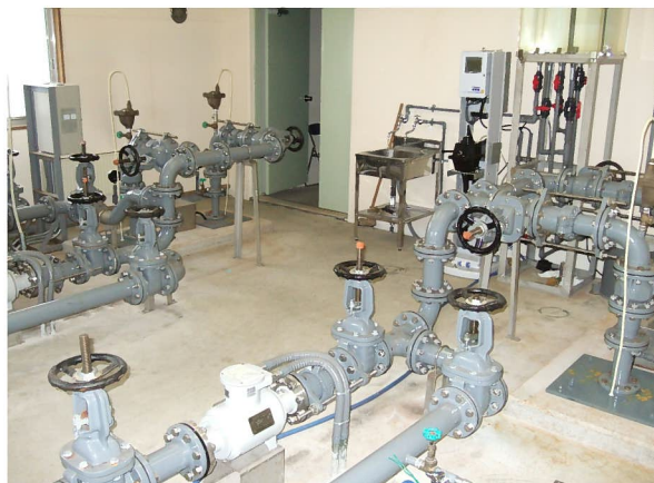
茂辺地ポンプ場
