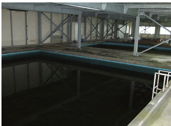
茂辺地浄水場
